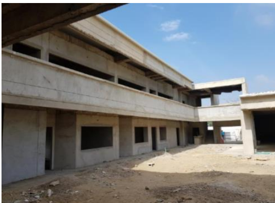
Ilustración 6. Estado de obra luego de liquidación de contrato LIC-PUB-011- 2016. Fuente: Informe final del contratista Consorcio CDI Villas de Aranjuez 2016.
