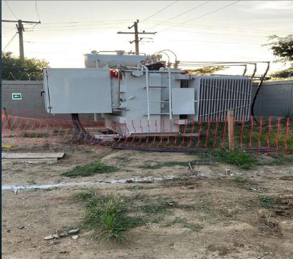
2do TR SE Sampués 34.513.8kV 5MVA
