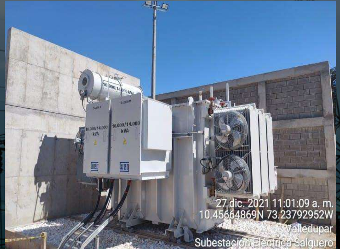
3er TR SE Salguero 34.513.8kV 14MVA
