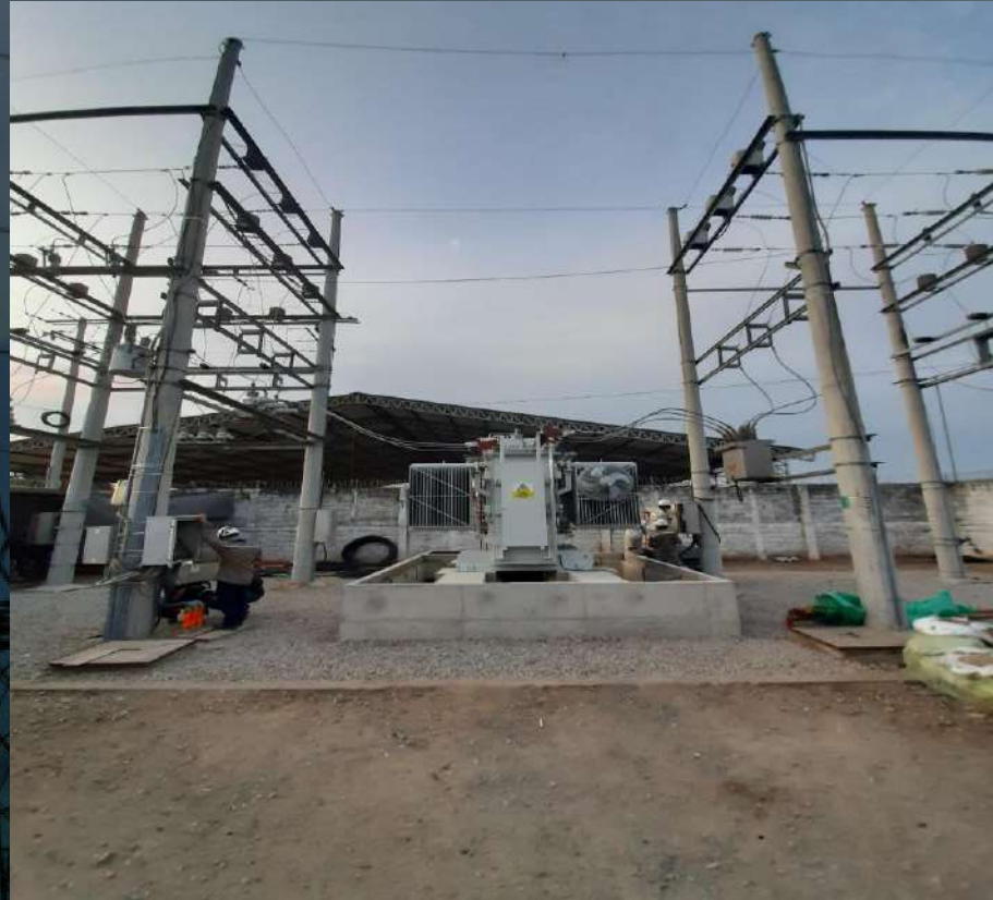
NUEVA GRANADA T III 6.5 MVA
