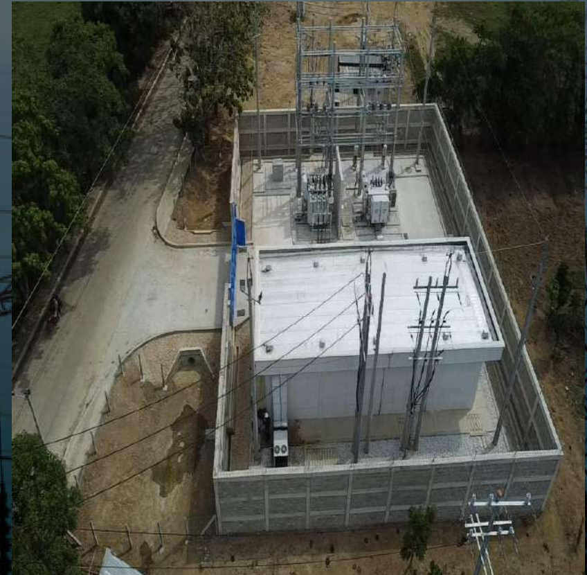
2do TR SE Cotorra 34.513.8kV 4MVA
