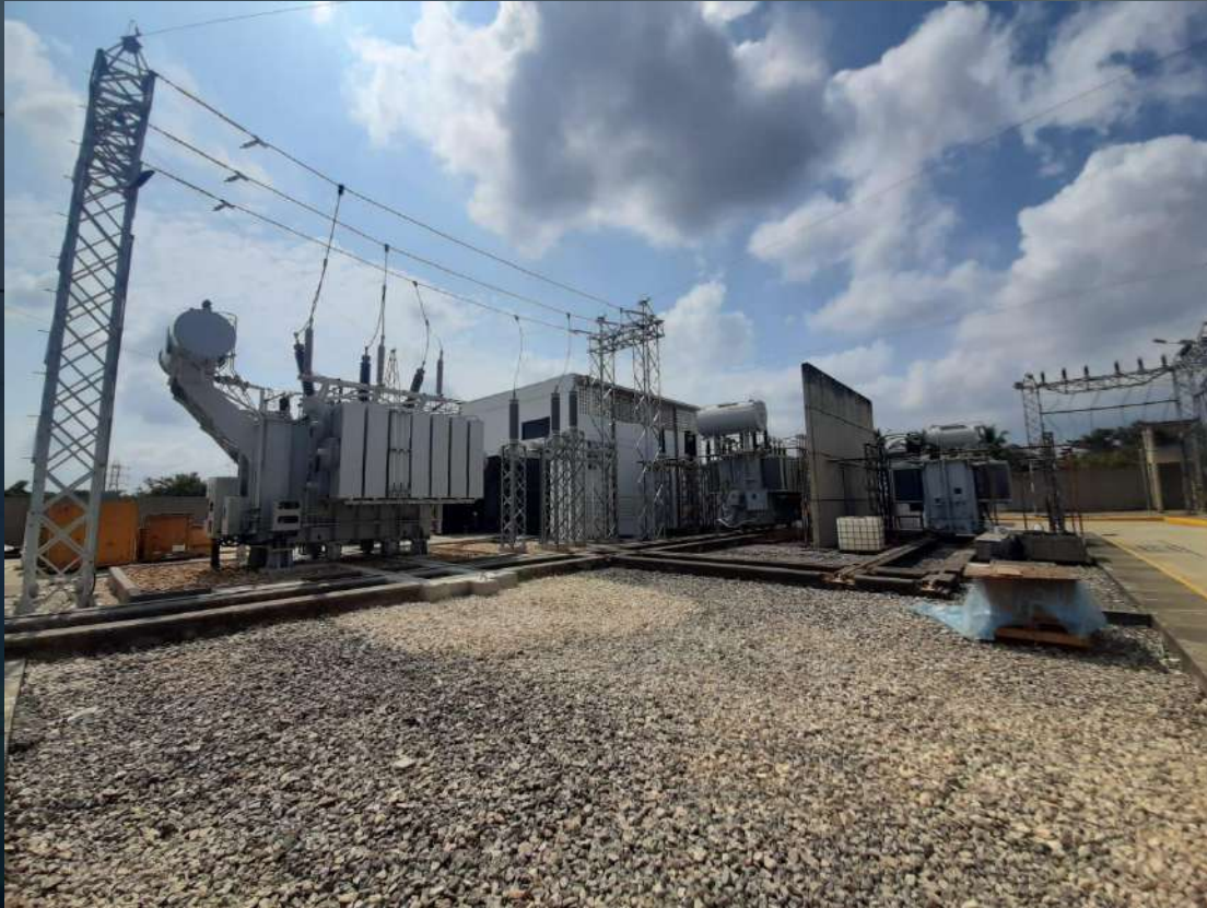
2do TR COVEÑAS 11034.5kV 60MVA 2021
